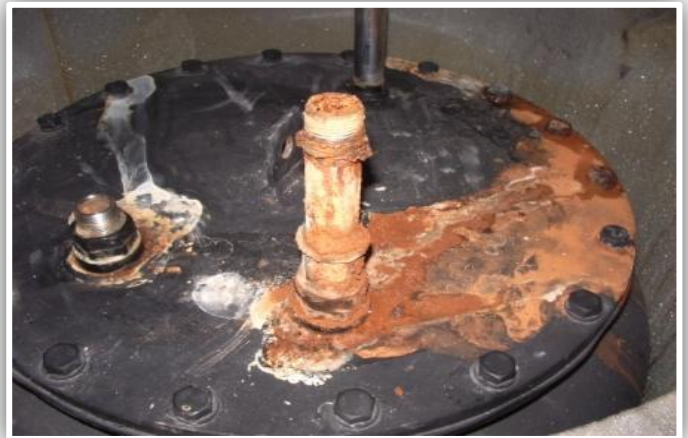
Tuyaux criblés et corrodés
