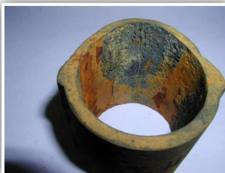
Conduites corrodées et tarrées
